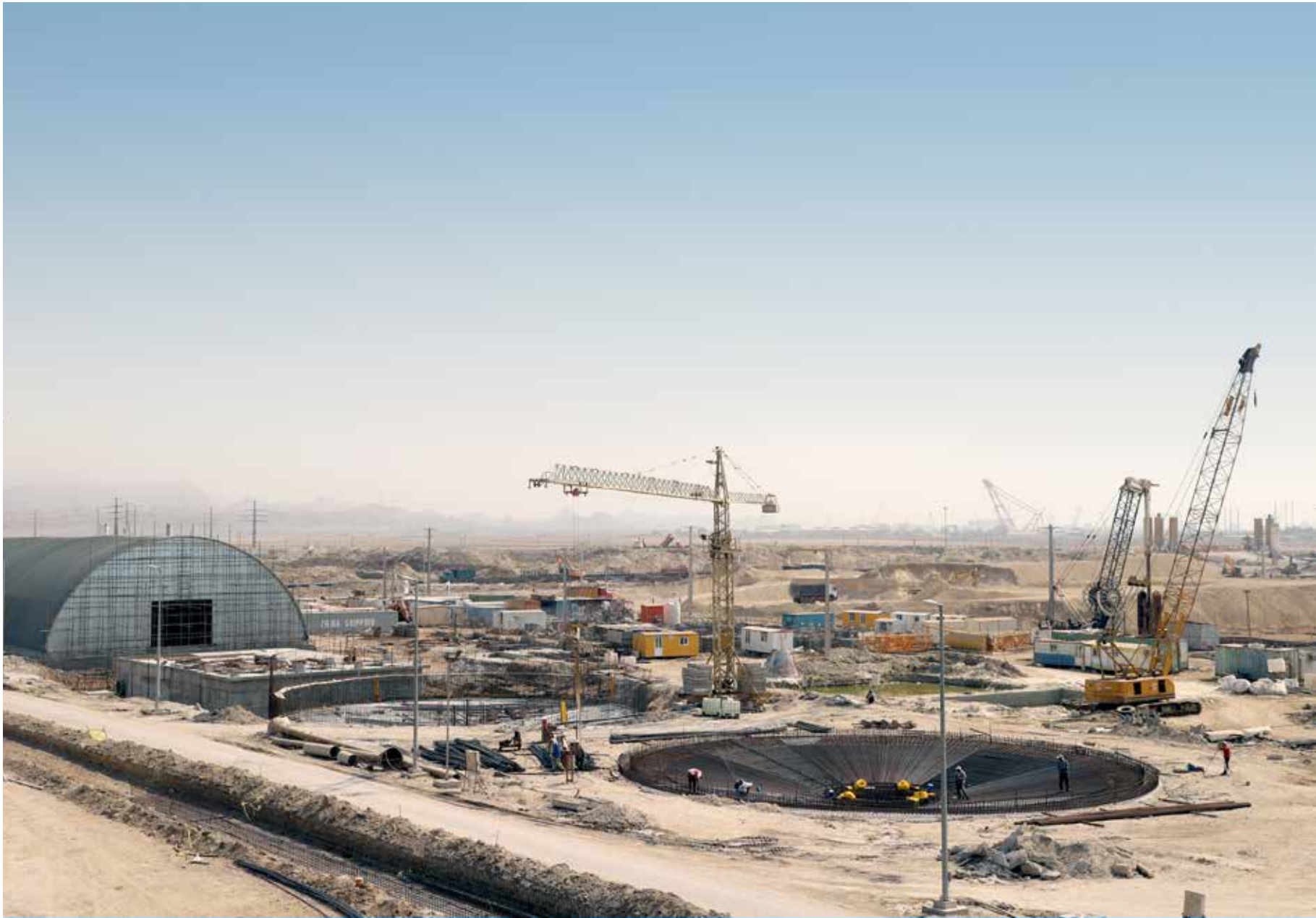
Водоопреснительная станция на 200000 м 3 в Бандар-Аббасе
