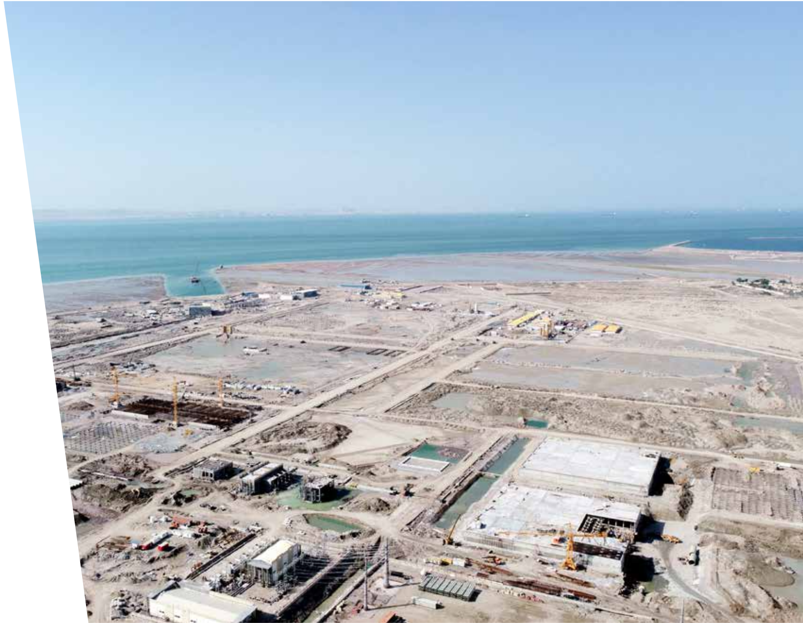
Водоопреснительная станция на 200000 м 3 в Бандар-Аббасе
