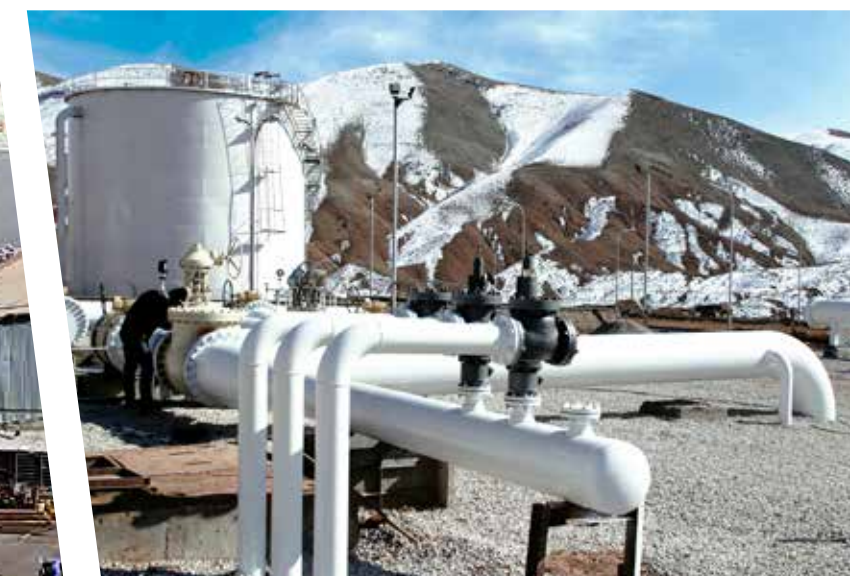
Насосные станции и сооружения нефтепровода для сырой нефти Нека – Рей
